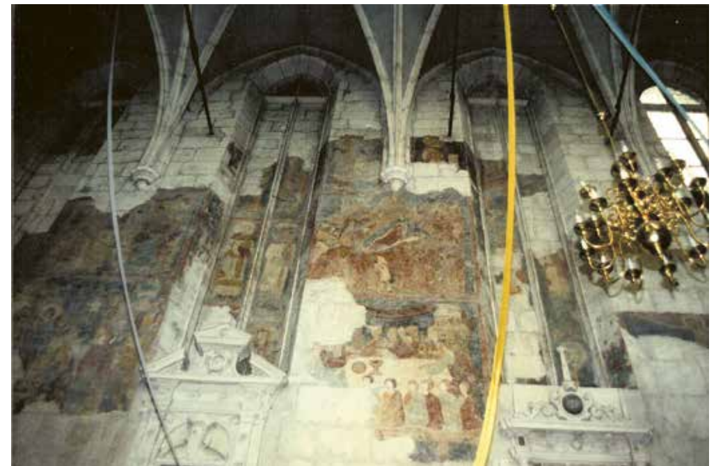
Fot. 2. Ściana północna, stan przed konserwacją, fot. M. Stec
