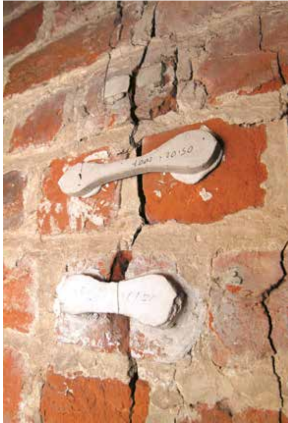
Fot. 7. Spękania wążku ceglanego muru, 2007, fot. J. Żuk-Orysiak
