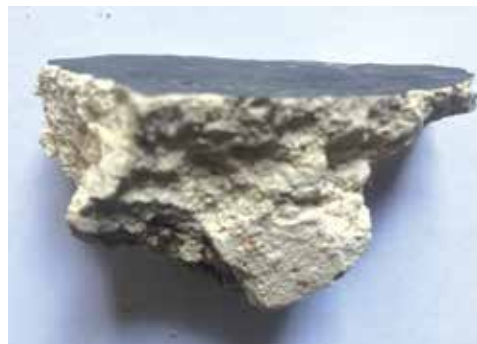
Fot. 5. Próbk nr 5 - tynk ze spękania ze ściany południowej z prezbiterium
