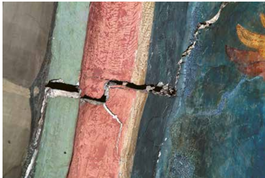
Fot. 8. Uczytelnienie spękań w partii sklepienia, fot. J. Żuk-Orysiak
